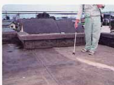
屋上からの漏水のため最上階のシーリングにエフロが発生(写真上)。屋上面を高圧洗浄後、全面にナノコンシーラを塗布。
