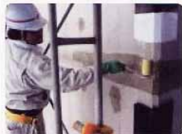
東京都・中防ヶ森作業所 クラック抑制、劣化防止、収縮抑制の目的でナノコンシーラを塗布。
