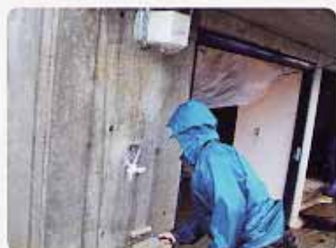
長岡市市営住宅新築工事(旧山古志村) コンクリート基礎のクラック防止と凍結融解劣化防止の目的でナノコンシーラを塗布。
