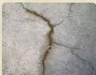
凍結融解作用によりコンクリートにひび割れが生じた外階段の床面。
