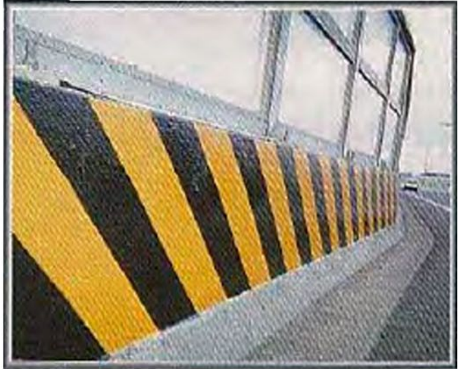
道路 融雪剤・塩害・汚れ
